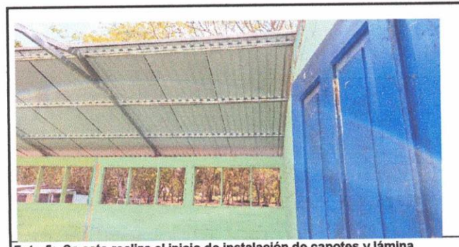
Foto 5: Se esta realiza el inicio de instalación de capotes y lámina troquelada
