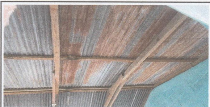
Foto 5: antes del proceso Las laminas estan muy oxidadas y tienen agujeros y goteras en todas las aulas.
