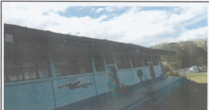
Foto 3: antes del proceso El techo esta desanivelado y las laminas en gran parte ya no cuentan con el soporte necesario para permanecer funcionando.
