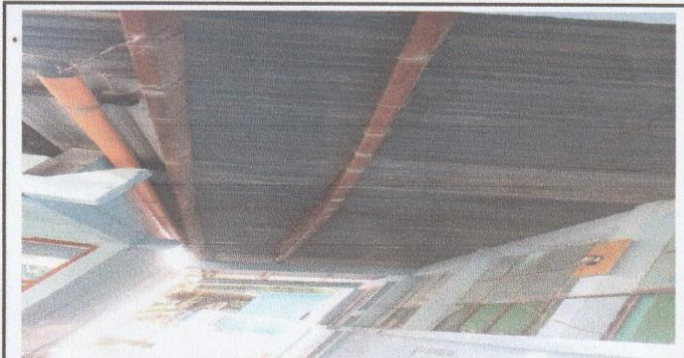
Foto 2: La estructura del techo demuestra que esta al borde del colapso por la corrosión y deterioro al que permanece expuesta
