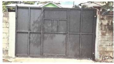
Foto 4: Portón de entrada sustituido
