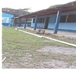
Foto 3: Desprendimiento de canal de agua
