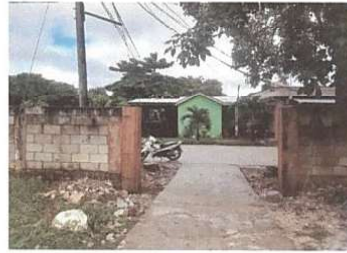
Foto 4: Porton de entrada en mal estado
