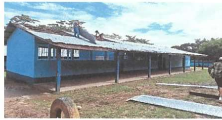
Foto 2: Capotes y laminas en mal estado
