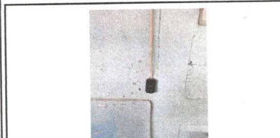
Foto 5: Sustrucción de ducto eléctrico + accesorios
