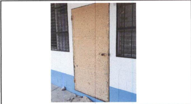
Foto 1: Puertas de Metal: Mantenimiento
