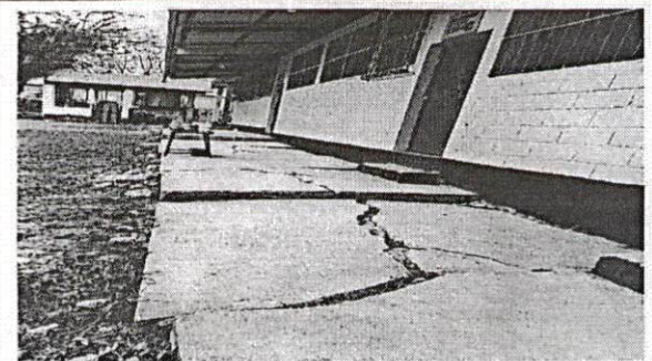
Foto 4: VISTA FRONTAL DEL MÓDULO 1, SE OBSERVA LA NECESIDAD DE SUSTITUIR LA BANQUETA.
