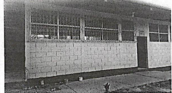
Foto 2: VISTA DE LA PARTE FRONTAL DEL SALON 1, SE APRECIA QUE NECESITA CAMBIO DE PUERTA, BALCONES, PINTURA Y BANQUETA.
