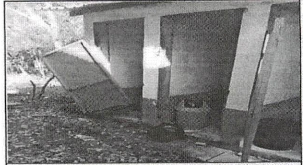
Foto 2: El deterioro de estas puertas es tanto que no se pueden recuperar en lo absoluto, la única solución es cambiarlas totalmente por puertas de metal, y cambiar también la salida de pozo ciego a lavables.
