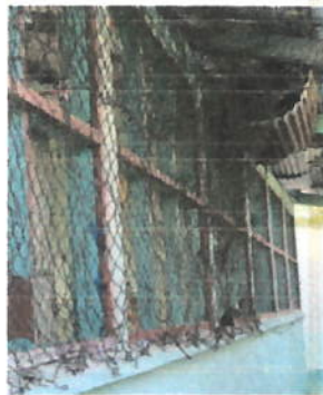
Foto 2: AULA (A), LAS PUERTAS MUESTRAN DETERIORO EN EL METAL Y LOS MARCOS YA NO ESTÁN EN BUEN ESTADO.
