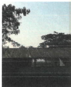
Foto 4: EL TECHO DEL AULA (A) ESTÁ EN MAL ESTADO Y LA LÁMINA PRESENTA FILTRACIONES DE AGUA.
