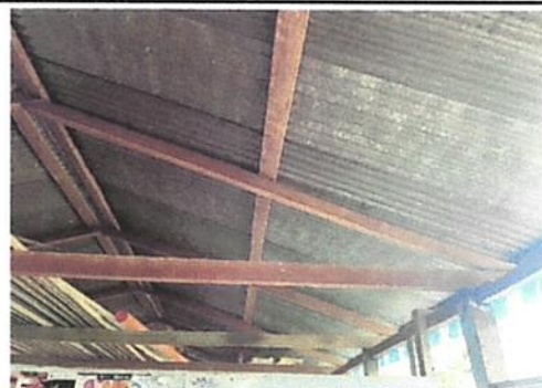
Foto 4: Aquí se puede ver la otra parte del techo en la parte de atrás
