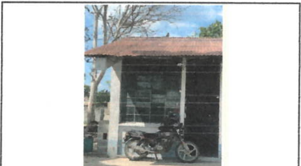
Foto 4: AULA (A), LA ESTRUCTURA DE ACERO EXHIBE DEFORMACIONES Y CORROSIÓN.
