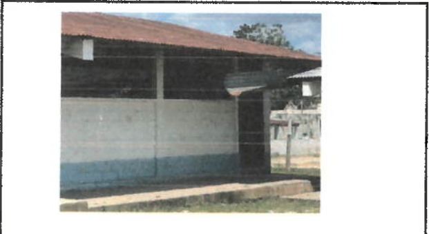
Foto 3: AULA (A), SALÓN CON LÁMINA DETERIORADA Y FILTRACIONES.
