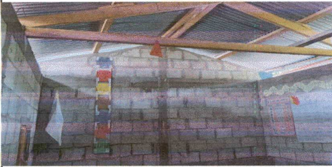
Foto 3: VISTA INTERIOR DE MODULO 1, SE APRECIA LA FALTA DE REPELLO EN EL INTERIOR DE LOS MUROS
