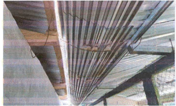
Foto 2: VISTA DE LA FALTA DE CANAL DE AGUA, POR LO QUE SE MOJA EL AULA QUE SE ENCUENTRA AL COSTADO DEL MODULO 1
