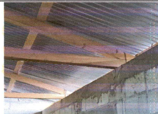
Foto 6: VISTA INTERIOR DE MODULO 1, SE VISUALIZA LOS ELEMENTOS DE MADERA QUE CARGAN LA CUBIERTA, SE ENCUENTRAN CON EVIDENCIAS DE DETERIORO
