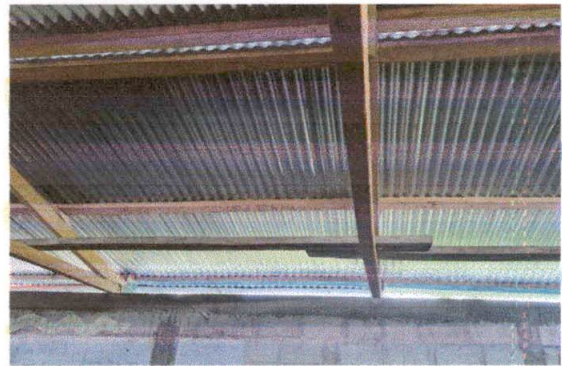
Foto 4: VISTA DE CUBIERTA, SE APRECIA EL MAL ESTADO DE LA ESTRUCTURA PORTANTE
