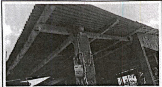
Foto 1: vista del módulo, se aprecia que necesita un cambio de techo.
