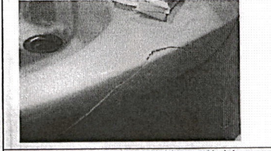
Foto 6: vista del módulo, se ve la necesidad de un cambio de lavamanos.
