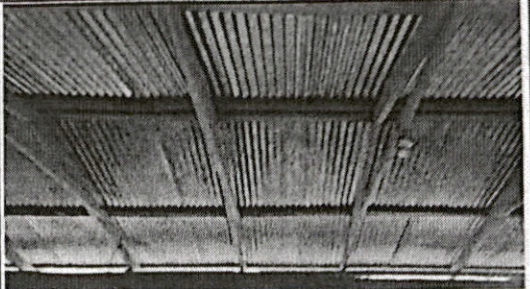
Foto 2: vista del módulo, se observa la necesidad del cambio de estructura.
