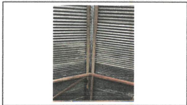
Foto 2: EL TECHO DE LA COCINA PRESENTA UN AGUJERO.
