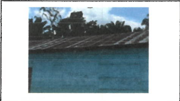
Foto 3: LA CUBIERTA DE LÁMINA EN LA COCINA ESTÁ CORROÍDA Y TIENE FILTRACIONES.
