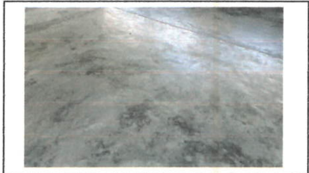
Foto 4: EL SUELO DE LA COCINA ESTÁ EN MAL ESTADO, PRESENTA FISURAS Y LEVANTAMIENTOS.
