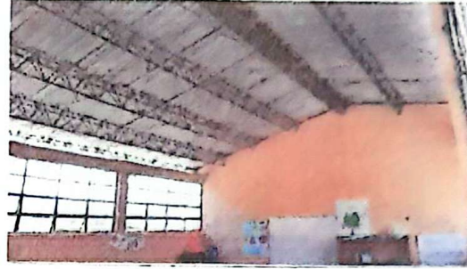
Foto 2: Estructura y Cableado Eléctrico
