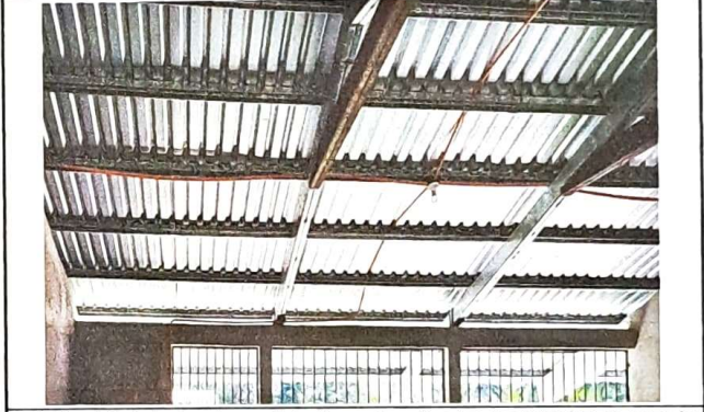
Foto 8: vista interior de modulo 1, se visualiza las instalaciones para la instalación de lámparas led
