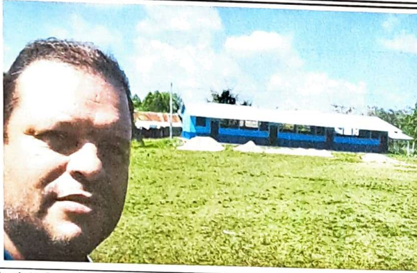
Foto 1: vista frontal de centro educativo, no cuenta con rotulo de identificación
