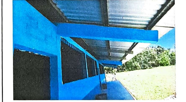
Foto 10: vista externa de modulo 1, se aprecia la aplicación de pintura en muros
