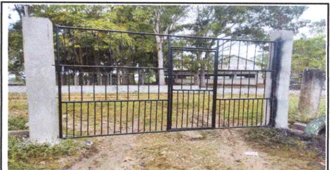
Foto 6: Renglón 12.1. Este trabajo fue el mantenimiento de portones para seguridad de nuestra Escuela, todos los establecimiento requiere con mas seguridad con portones cerrados.
