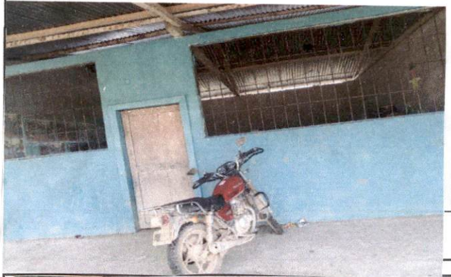
LAMINAS Y BIGAS EN MAL ESTADO Y 2 AULA SIN PINTURA
