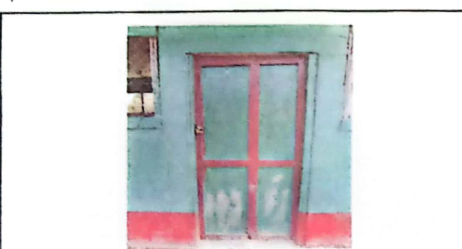
Foto 5: cambiar la puerta por lamina de metal
