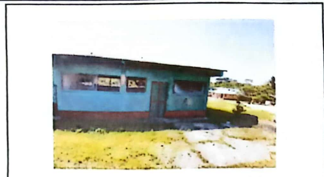
Foto 2: Están en mal estado en la pintura
