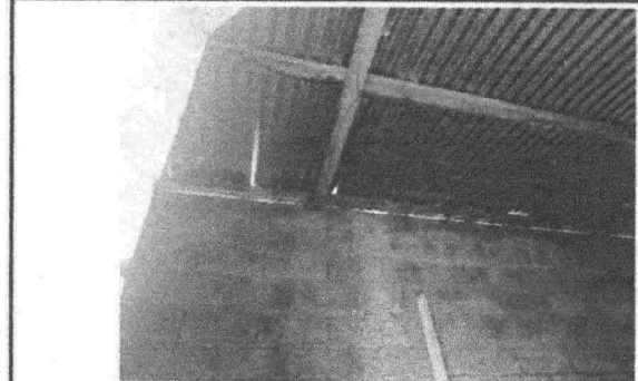
Foto 2: Estructura de Techo en mal estado
