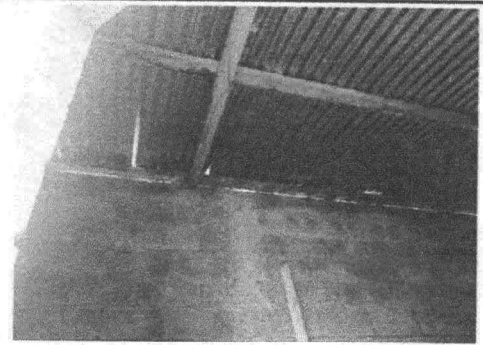
Foto 2: Estructura de Techo en mal estado
