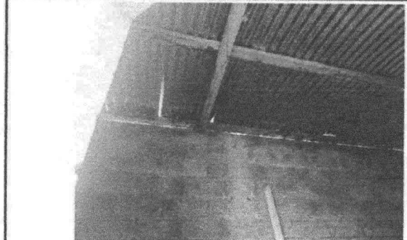
Foto 2: Estructura de Techo en mal estado
