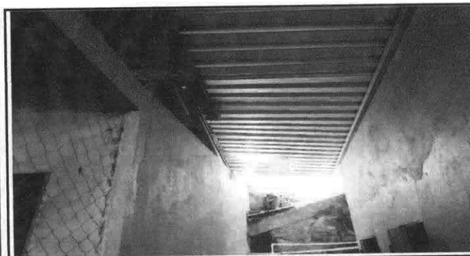
Foto 11: Sustrucción de ducto eléctrico + accesorios.
