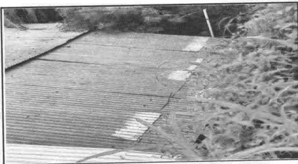
Foto 5: Se cambiará estructura y techo.
