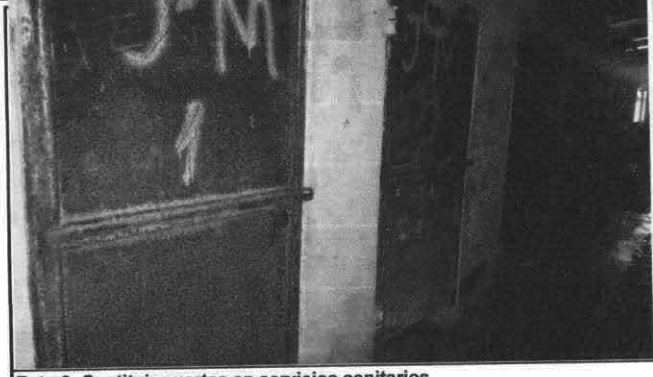
Foto 8: Sustruir puertas en servicios sanitarios.
