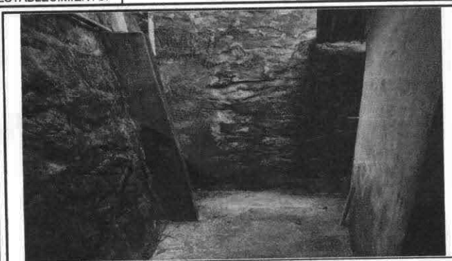
Foto 7: Sustrución de mingitorio (por motivo que el mingitorio es tradicional y está en mal estado, se le dará mantenimiento).
