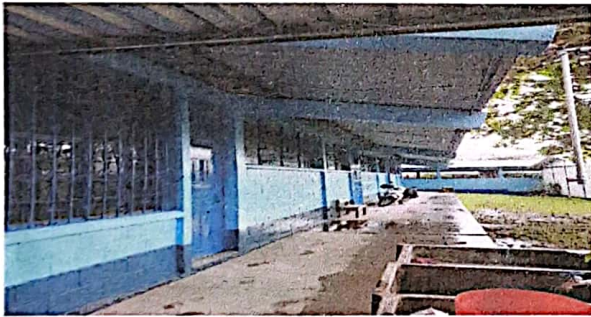
Foto 3: Soporte de estructura
