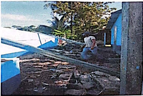
Foto 3: Soporte de estructura
