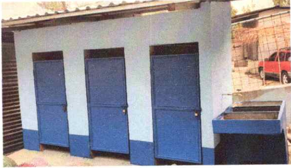
Foto 1: TECHO Y PUERTAS DE SANITARIO
