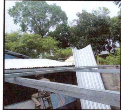
Foto 2: Sustitución de estructura de soporte de madera por metal en ampliación de cocina
