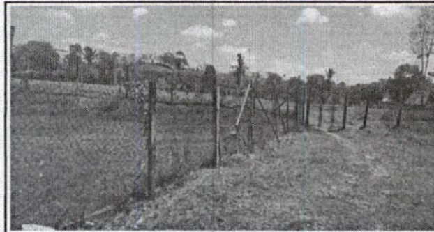
Foto 3: Sustrucción de malla por muro perimetral.
