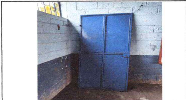
FOTO 1: Mantenimiento a estructura (lijado, cambio de tubo, cepillado, sujeciones, aplicación de pintura)
