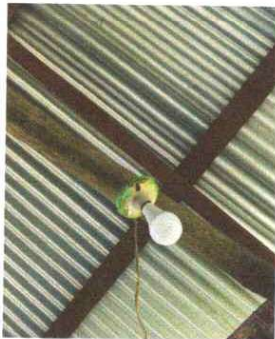
Foto 5: SUSTITUCION DE LAMPARA TIPO LED
