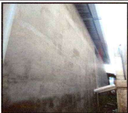
Foto 9: Cernido en paredes de cocina
