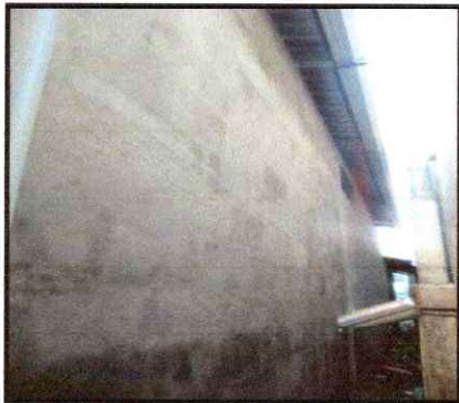
Foto 9: Cernido en paredes de cocina
