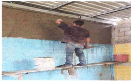
Foto 9: Repello en paredes
