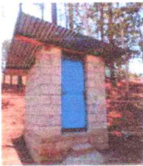
Foto 3: Puerta de metal de baño
