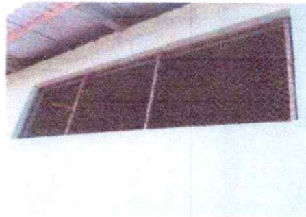
Foto 6: Ventanas de metal
