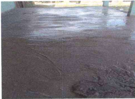
Foto 3: Sustrucción de Piso de Torta de Concreto
