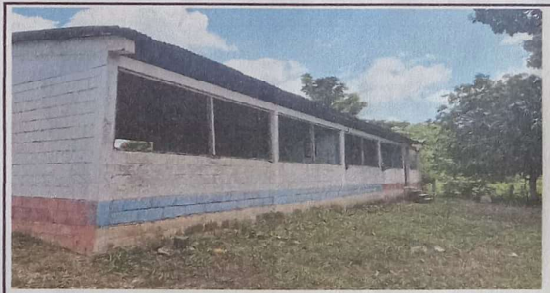
Foto 6: INTURA EN MUROS INTERIORES Y EXTERIORES
