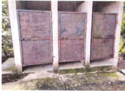
Foto 1: Puerta de baños deterioradas, parte exterior.
