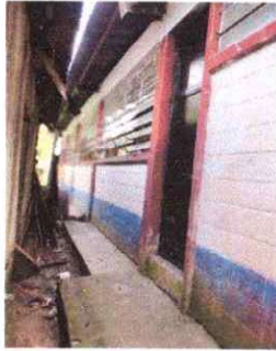
Foto 3: Ventanas y vidrios en mal estado.
