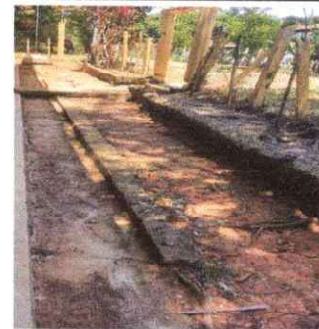
Foto 6: Cunetas en mal estado.
