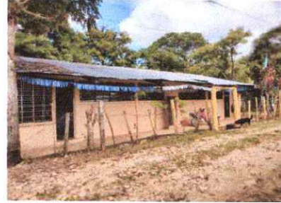
Foto 2: Techo de las aulas y direccion en mal estado.
