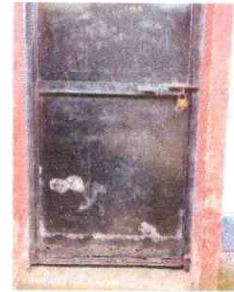
Foto 4: Puerta de la bodega deteriorada, parte anterior.
