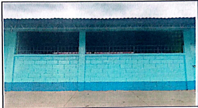
Foto 2: Vidrios por Balcon
