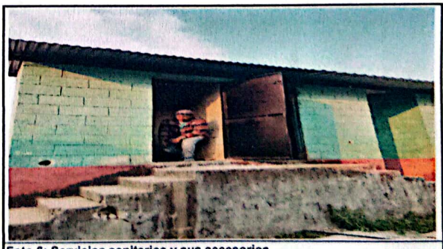
Foto 6: Servicios sanitarios y sus accesorios
