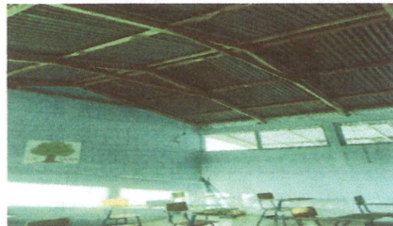
Foto 4: se cambiará madera por metal
