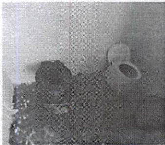
Foto 5: Estado actual de las letrinas
