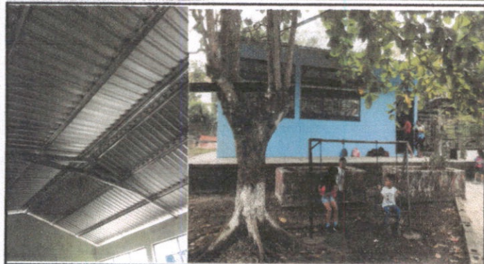
Foto1: Vista general de la lamina del aula de etapa 3
