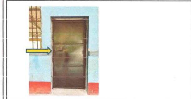
Foto 7: Sustrucción de chapa del Establecimiento
