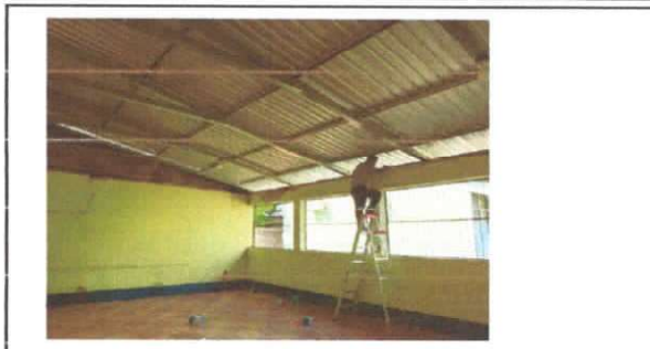
Foto 8: Sustrucción de lamparas tipo LED
