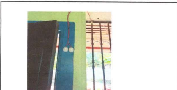
Foto 11: Sustrucción intrruptores dobles
