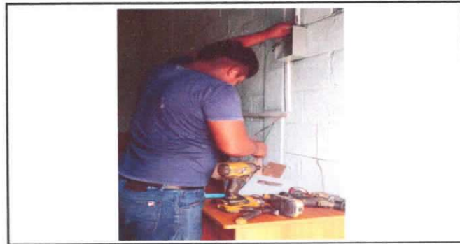
Foto 12: SUSTITUCIÓN DE LÁMPARAS TIPO LED
