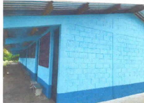
Foto 4: PINTURA EN MUROS EXTERIORES E INTERIORES, Pintura en muros exteriores e interiores
