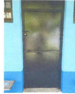
Foto 2: PUERTAS DE METAL, Mantenimiento a estructura (lijado, cambio de tubo , cepillado, sujeciones, aplicación de pintura)
