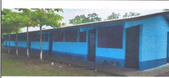
Foto1: CUBIERTA DE LAMINA, Sustitución de lámina, por lámina troquelada aluzinc calibre 28, Sustitución de capote de lámina para lámina troquelada, Sustitución de elementos de fijacion
