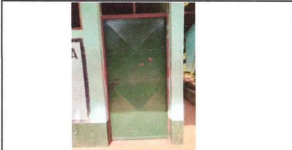
Foto 9: Mantenimiento a estructura (lijado, cambio de tubo, cepillado, sujeciones, aplicación de pintura)
