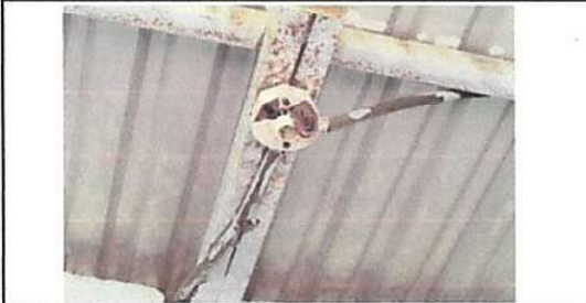
Foto 6: Sustrucción de plafoneras
