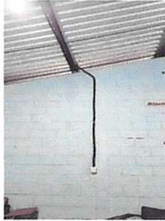
Foto 7: Sustrucion de ducto electrico mas accesorios
