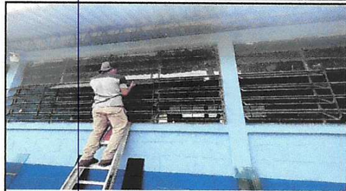
Foto 8: Sustrucción de vidrios
