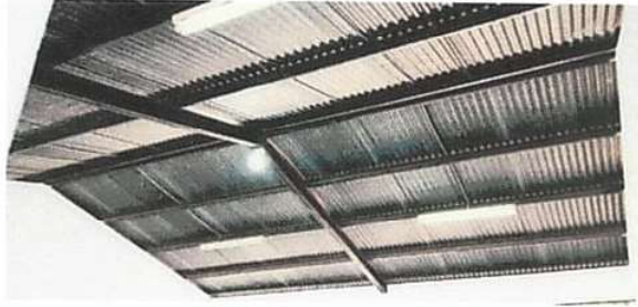
Foto1: Sustitución de lámpara tipo LED
